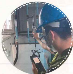
設備機房溫度檢測
