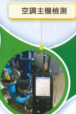
設備機房溫度檢測
